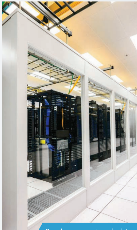
Paredes para centros de datos
