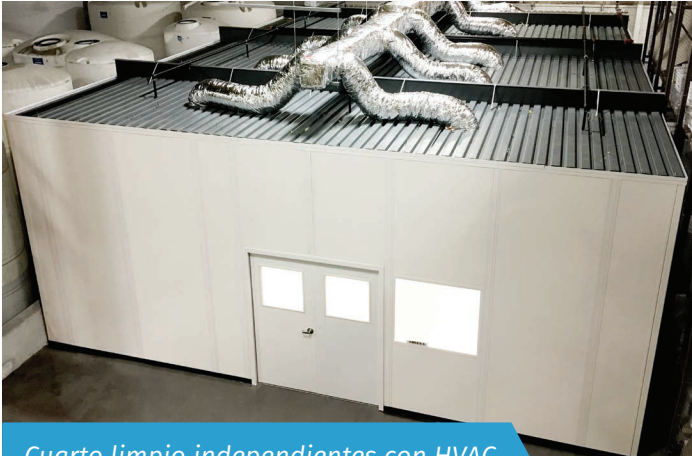
Cuarto limpio independientes con HVAC
