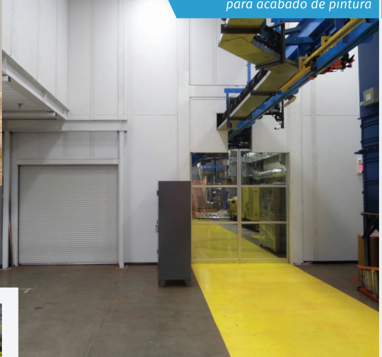
Recinto de ambiente controlado para acabado de pintura
